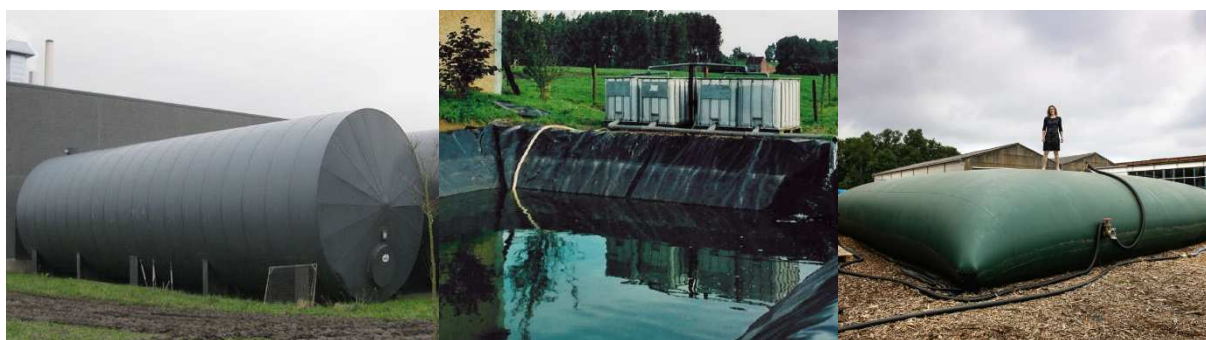
Figuur 99. Buffertanks, een foliebekken en een zak, voor de opslag van regenwater (Bron: Departement Landbouw en Visserij; Provincie Oost-Vlaanderen; De Standaard).
